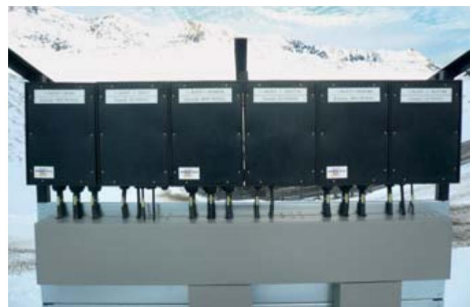
PST „Gaisberg“/Obergurgl: Zwischenklemmverteiler 400V und 24V für die 3 Vorpumpen.
