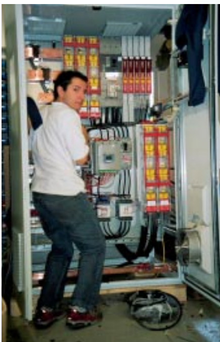
95 Schaltschränke werden heuer bei Elektro Berchtold für die kommende Schneisaison gefertigt.
