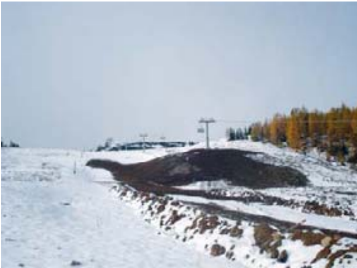
Diese nicht fertiggestellte Piste wurde im Winter vermessen, um das Gelände im Frühjahr korrigieren zu können.
