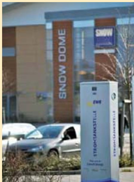
Auf dem Parkplatz des SNOW DOME Bispingen wurde Anfang April eine EWE Solarstromtankstelle platziert. Foto: SnowDome
