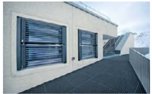
Röhrenkollektoren an den Südfenstern gewinnen Solarwärme.
